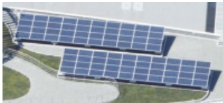
太陽光発電設備設置の例
